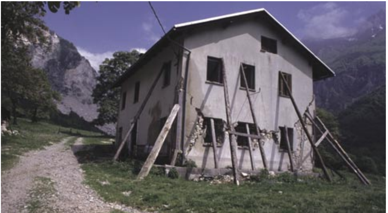
Slika 2: Zaradi potresa močno poškodovano sirarno na planini Polog so kasneje v celoti porušili in zgradili nadomestno (foto: Miha Pavšek).
