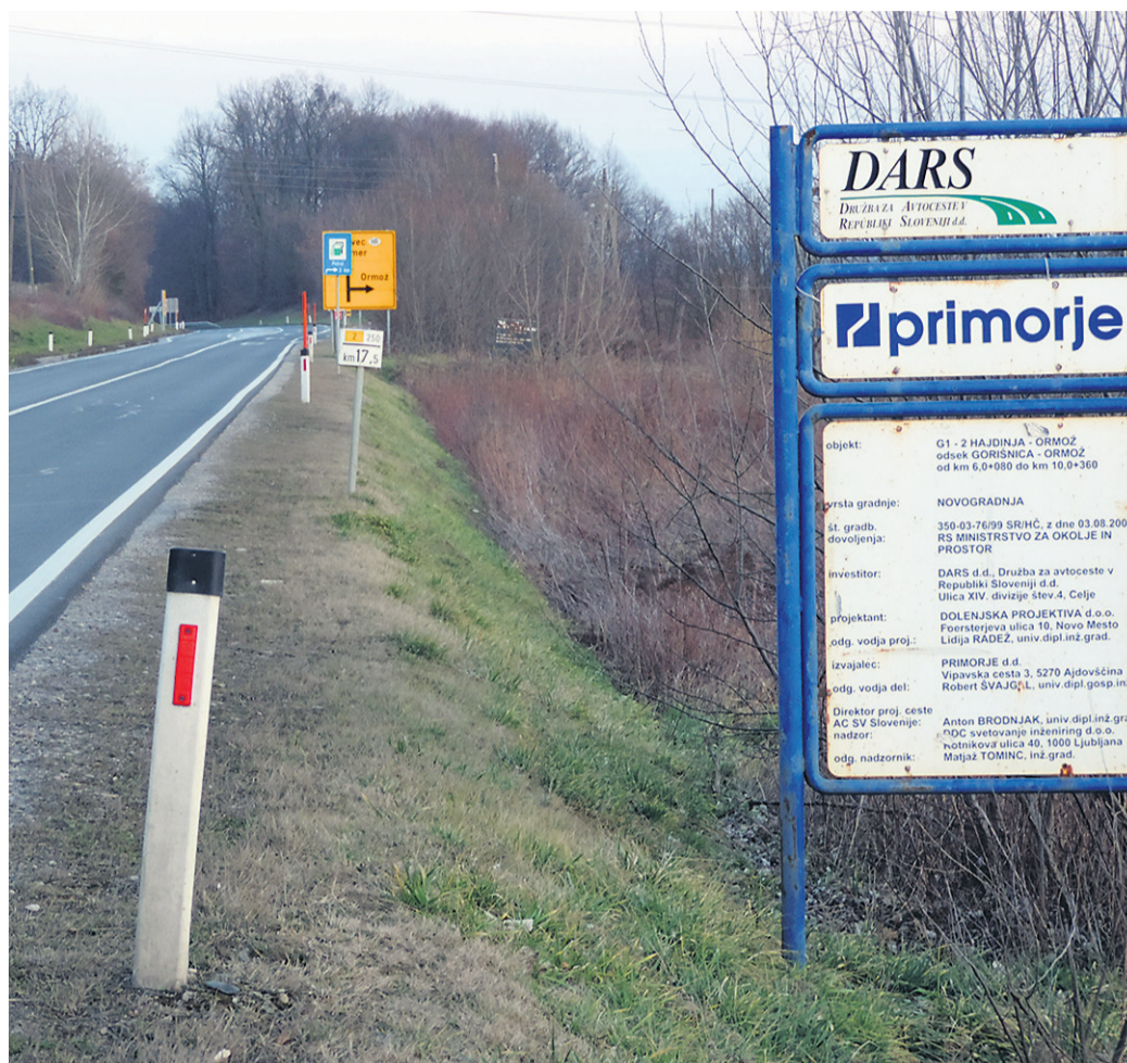
Zdelana tabla izvajalca opominja na zadnji neuspešen začetek gradnje ceste ...
