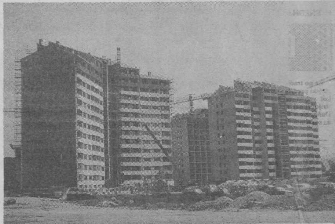
Predvidoma konec septembra bodo v novo sosesko Fužine prišli prvi stanovalci. Vseljivi bosta stolpnici B 24, 25 in B 26, 27, v katerih bo 52 stanovanj (Foto D. J.)
