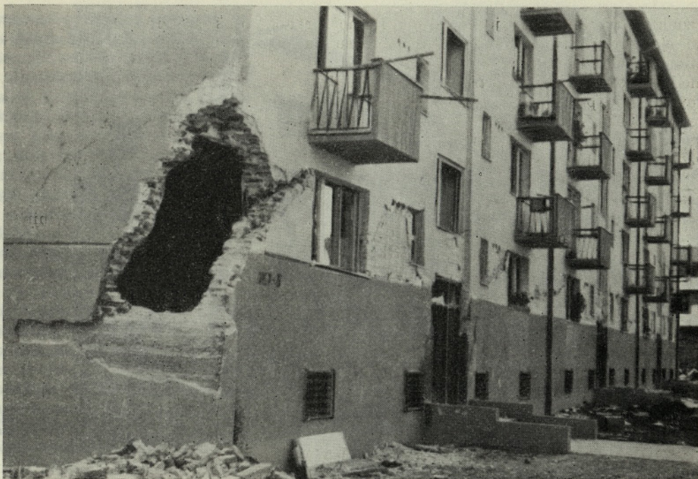
Značilne poškodbe zidanih stanovanjskih blokov v pritličju
