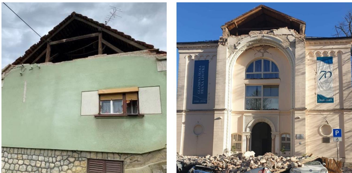
Slika 2.7: Porušitev zatrepnega zidu pri stanovanjski hiši ob potresu v Zagrebu (So et al., 2020) (levo) in porušitev zatrepnega zidu javne zgradbe ob potresu v Petrinji ( https://www.emsc-csem.org/Earthquake/264/M6-4-CROATIA-on-December-29th-2020-at-11-19-UTC ) (desno).
