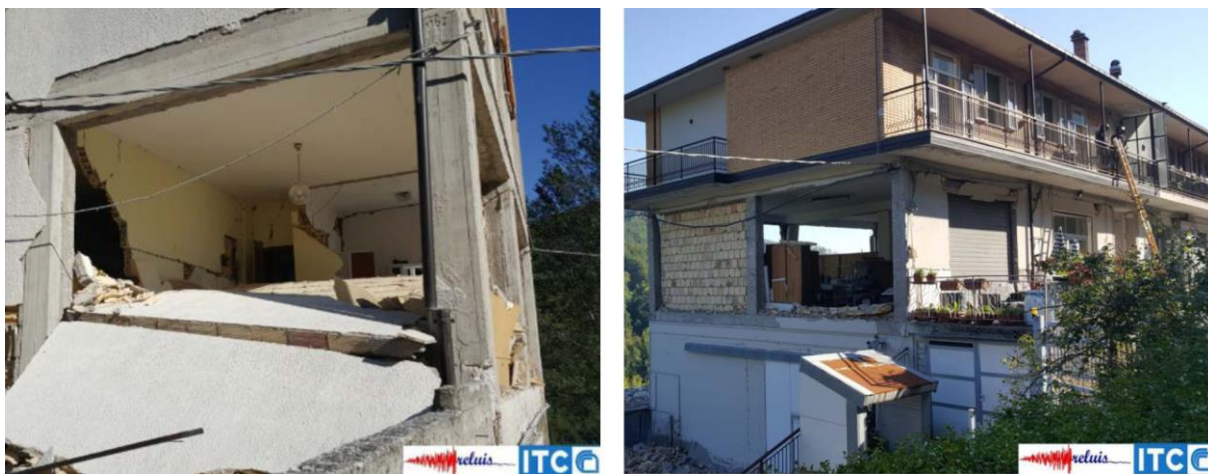
Slika 2.5: Potres v centralni Italiji: Izvenravninska porušitev zidanih polnil (Celano et al., 2016).
