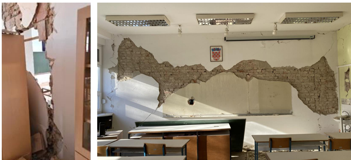
Slika 2.6: Potres v Petrinji: Izvenravninska porušitev predelnega zidu iz votlih opečnih zidakov (Miranda et al., 2021) (levo) in nearmiranega zidu iz polne opeke v javni zgradbi
