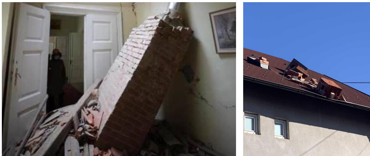
Slika 2.8: Porušitev in padec opečnega dimnika v notranjost zgradbe pri potresu v Zagrebu (So et al., 2020) (levo) in porušitev zidanega dimnika pri potresu v Petrinji ( https://www.emsc-csem.org/Earthquake/264/M6-4-CROATIA-on-December-29th-2020-at-11-19-UTC ) (desno).
