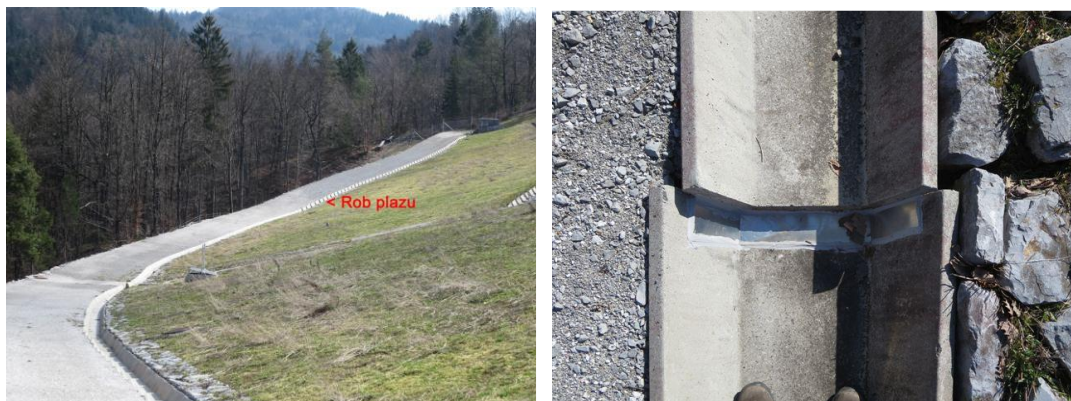
Slika 80: Severna skalometna peta, mesto prehoda preko roba plazu (levo), razmik kanalet in začasna zatesnitev prekritja kanalet (desno)
