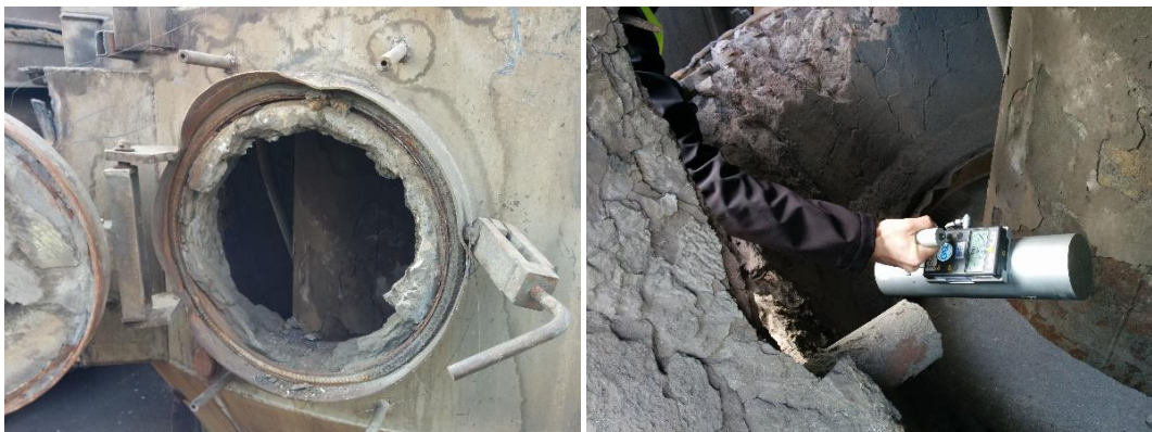
Slika 101: Pogled na del izrabljene industrijske peči, ki je vsebovala obloge s povišano vrednostjo naravnih radioizotopov (levo) in meritve dozne hitrosti, ki jo izvaja strokovnjak ZVD d. o. o. (foto ZVD d. o. o.)
