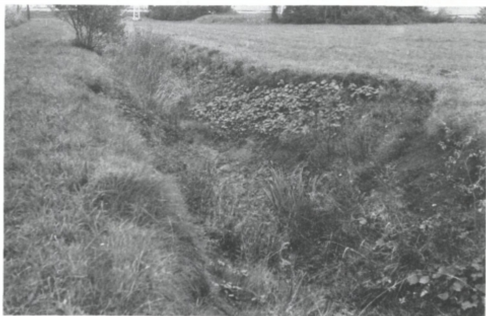
Sl. 9. Ugrez v jarku niže od Malenskega mlina v aluvialni ravnici Grosupeljščice-Dobravke
