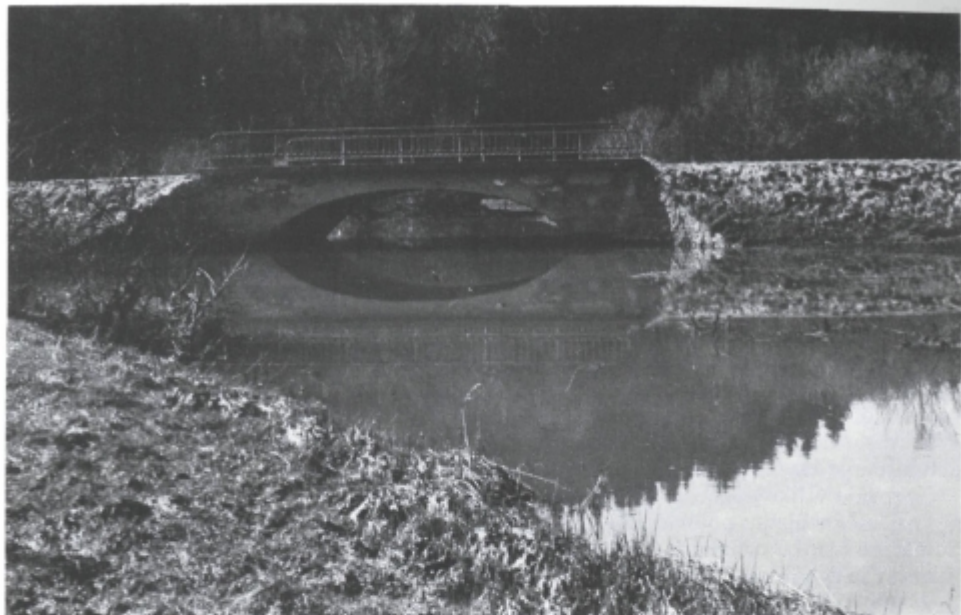
Sl. 24. Obseg pogostne srednje poplave ob mostu čez Dobravko jugozahodno od Boštanja; voda zalije približno dve tretjini mostnega prepusta
