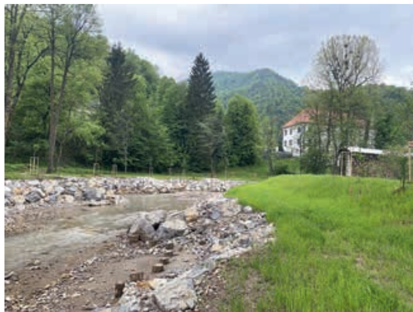
Območje prestavitve struge z utrjenimi brežinami iz skal in izdelavo tolmunov. Desno je viden protipoplavni nasip, levo zasaditve dreves in grmovnic.
