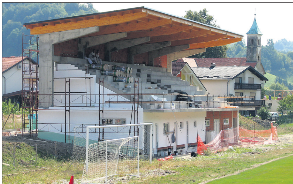
Izgradnja športnega objekta (slačilnice s pokrito tribuno) je v zaključni fazi, pogodbeno vrednost del je dobrih 450.000 evrov, večino denarja pa naj bi občina prejela iz razpisa za razvoj vasi.
