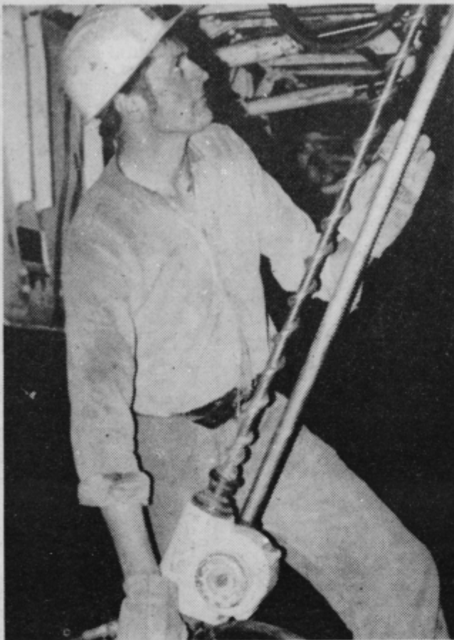
Vrtanje iz podkopenega dela v stropni del pri popolnoma mehaniziranem čelu DOWTY.
