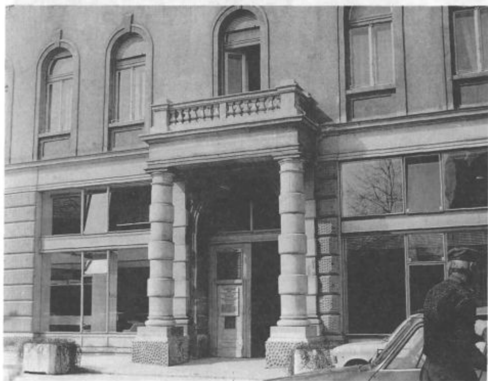
Slika 4: Rekonstruirano pritličje z vhodnim portalom ter balkonom. (Avtor fotografije Bogdan Badovinac, ZVNKD Celje, 1979.)
