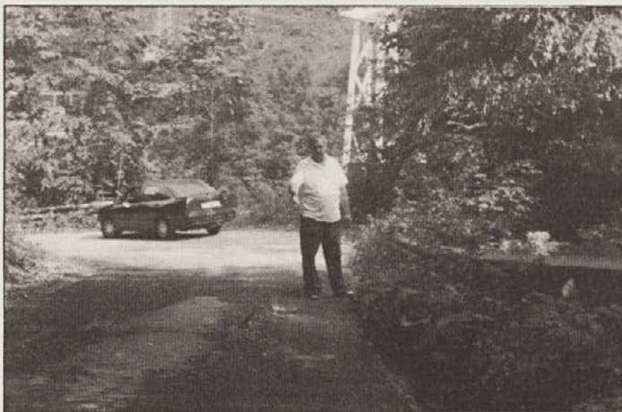
Predsednik KS Dobovec Albert Dolanc je opozoril tudi na razpoke v asfaltu.
