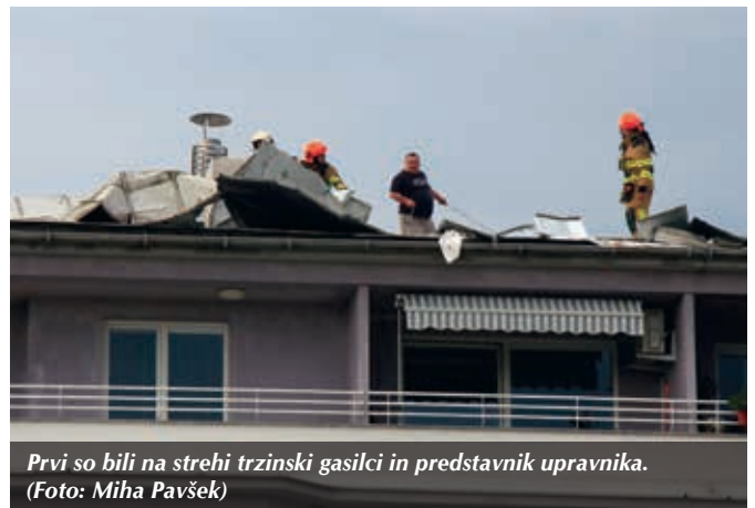
Del pločevinaste strehe je obležal za blokom, na odvetni strani stavbe. (Foto: Miha Pavšek)
