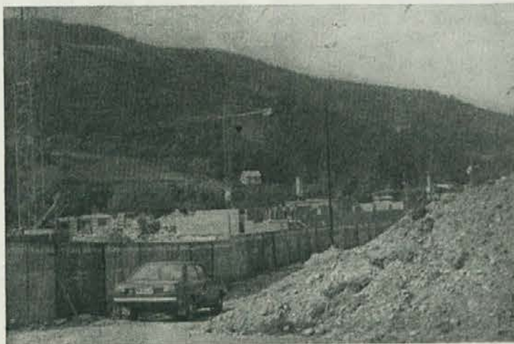
Gradbišče mehanične delavnice v Pamečah — uresničevanje želja delavcev TOZD Transporti in servisi — foto: F. Jurač
