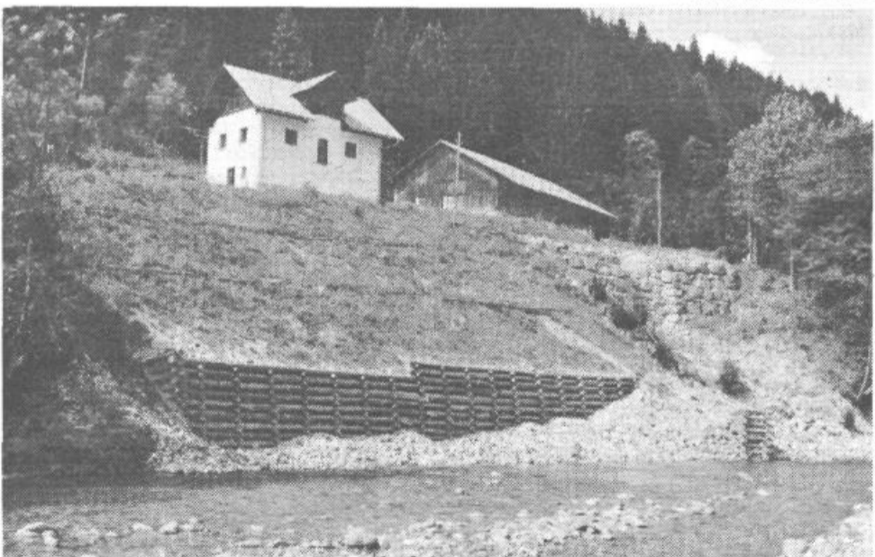
Tudi v hudourništvu uporabljajo v zadnjem času pristope in materiale, ki so bolj prijazni okolju. Tako so n.p. pri Prušnikovi domačiji nad Savinjo uporabili za varovanje brega pred deročo vodo leseno kašto, za zaščito brežine pred površinskim delovanjem vode zatravitev in vrbov poplet, strugo hudourniškega Pršnikovega grabna pa so utrdili s kamnito pregrado iz avtohtonega kamenja. (Foto: S. J.)
