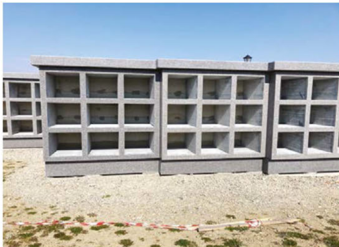
V spomladanskih mesecih nadaljujemo dokončanje ureditve žarnih zidov na pokopališču Videm, kjer že stoji 126 žarnih niš.
