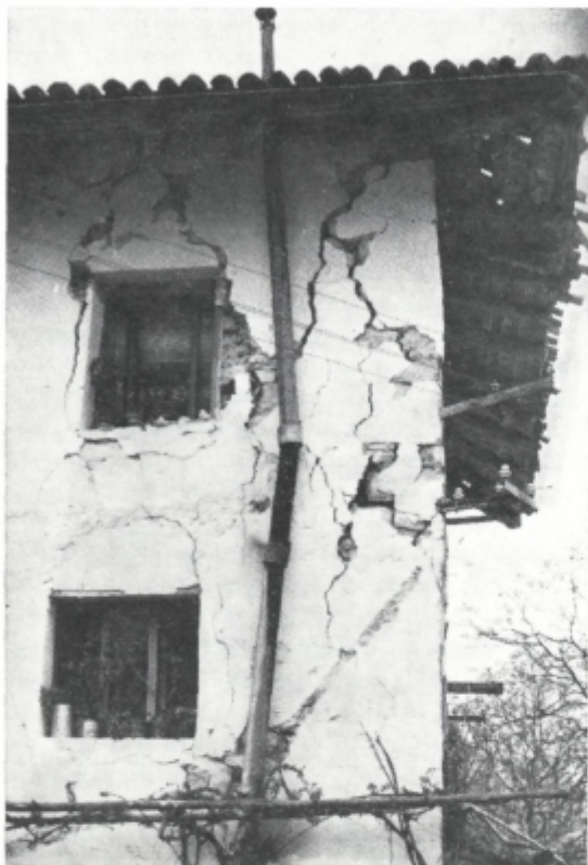
Sl. 1. Že po prvih močnih potresnih sunkih 6. maja 1976 so bile v Posočju močno poškodovane številne stavbe. Na fotografiji je primer poškodb na hiši v Podbeli, ki je bila že ob začetku potresne aktivnosti najbolj prizadeto naselje v Jugoslaviji. Fotografija je bila posneta 7. maja, ko še ni bila zaključena prva serija potresov. To stavbo so kasneje porušili, ker popravilo ni bilo več ekonomsko upravičljivo
