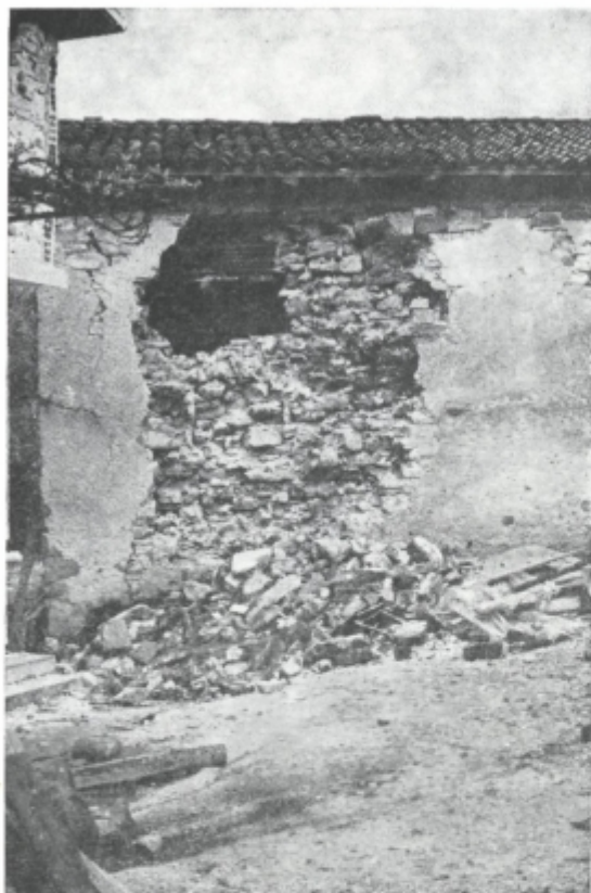
Sl. 5. Na tem posnetku iz Podbele je lepo vidno, kako je bil zgrajen zid hiše. Kamni so bili zloženi tako, da je bila stena ravna z zunanje in notranje strani, vezani z apnenim vezivom in ometom. Tak način tradicionalne gradnje je statično zelo slab in zato so bile tudi poškodbe tako katastrofalne
