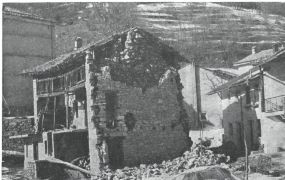
Sl. 10. Močno poškodovana hiša v Beneški Sloveniji, v kraju Tipana (Taipana); na tradicionalen način grajena hiša ni več uporabna, novejše zgradbe v sosedstvu so bile le neznatno poškodovane. V celoti je bila škoda zaradi potresa v sosednji Italiji izredno obsežna in za slovenski živelj v teh krajih katastrofalna
