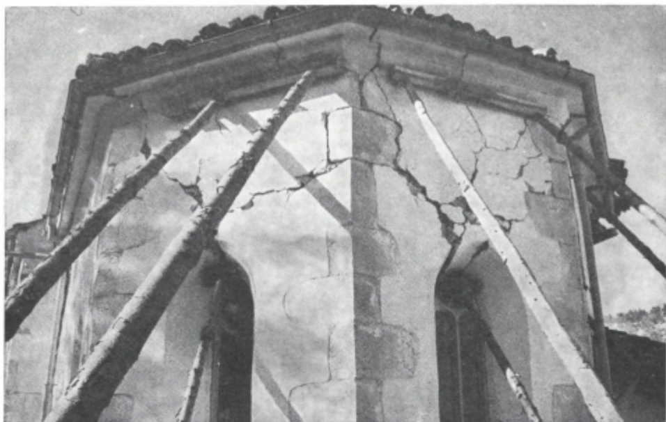
Sl. 17. Močno poškodovana apsida cerkvice na pokopališču nad Breginjem. Škoda na spomeniško zavarovanih objektih je bila izredno obsežna in je nismo mogli v celoti ovrednotiti
