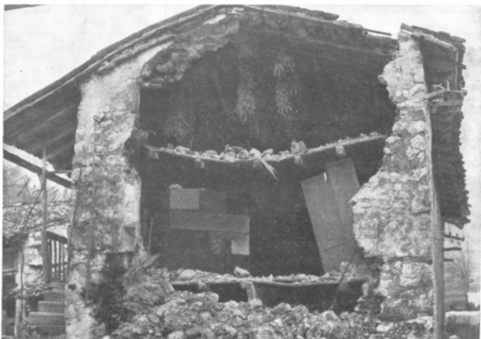
Sl. 2. Deloma porušena hiša v Breginju, posneto 7. maja 1976. Dobro je viden način gradnje starejših hiš, ki so utrpeli največ škode. Večina stavb v Posočju je bila zgrajenih na ta način. Kamen in les sta osnovni gradbeni material, konstrukcija stavbe je brez trdnejših vezi
