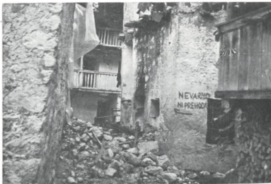
Sl. 14. Zaradi nevarnosti pred nepričakovanim rušenjem močno poškodovanih stavb so morali v Breginju in mnogih drugih krajih opustiti številne hiše
