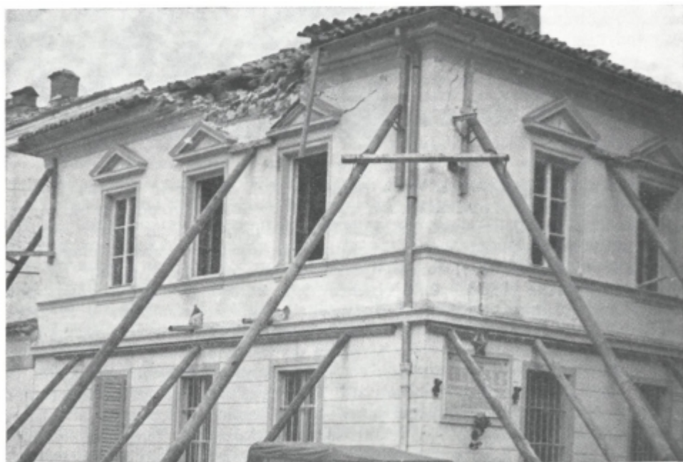
Sl. 20. Upravna stavba v Kobaridu po septembrski seriji potresov; v zgornjem delu hiše so dobro vidne nove poškodbe. Kasneje so morali odstraniti celotno zgornje nadstropje in so stavbo obnovili po nekdanjem videzu
