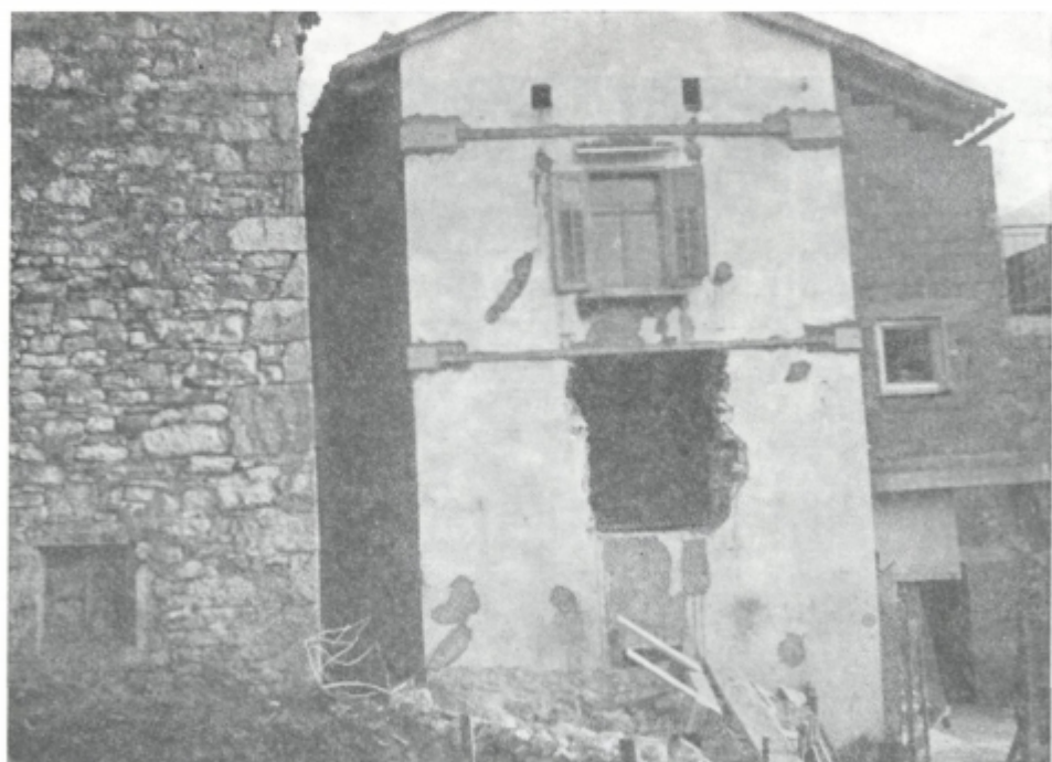
Sl. 22. V Logjih in mnogih drugih krajih v Posočju ter v Beneški Sloveniji so z uspehom uporabili tehnologijo Zavoda za raziskavo materiala in konstrukcij iz Ljubljane. S posebnim načinom vezi so statično utrdili in izboljšali konstrukcijo poškodovanih hiš. Ta tehnologija se je odlično obnesla, nove potresne sunke so te stavbe prestale brez dodatnih poškodb. Prav tej tehnologiji gre zahvala, da je ostalo mnogo hiš, ki bi jih sicer morali porušiti
