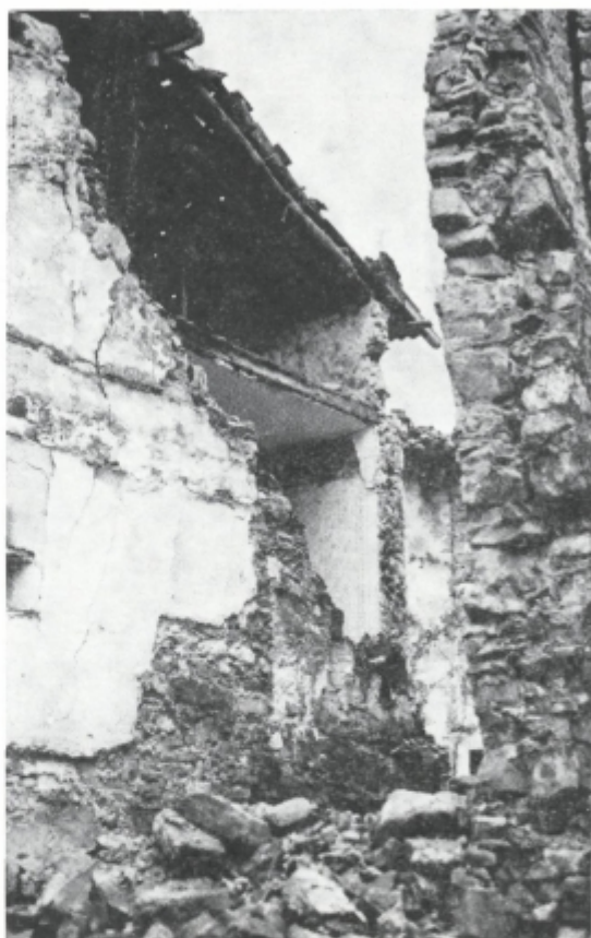
Sl. 4. V Podbeli so bile že ob začetku potresne aktivnosti mnoge stavbe tako močno poškodovane, da so se porušile
