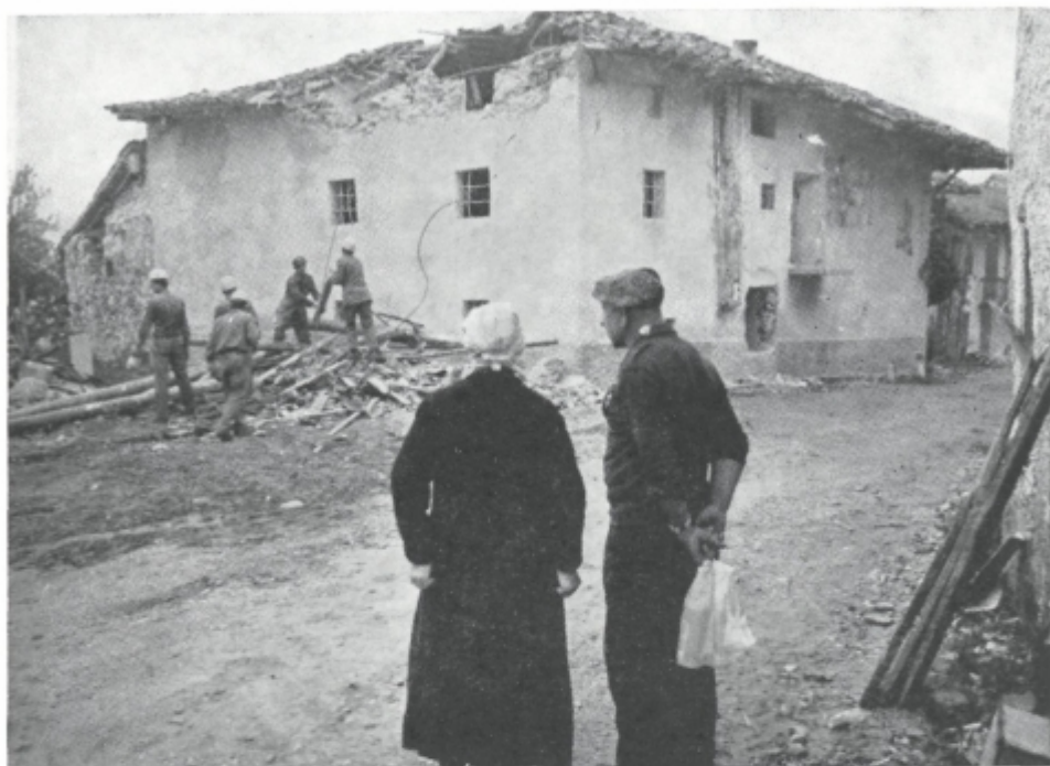
Sl. 18. Breginj je bil zaradi potresov tako močno poškodovan, da so ga morali skoraj v celoti porušiti. Ta hiša je bila pred potresom obnovljena in dobro vzdrževana
