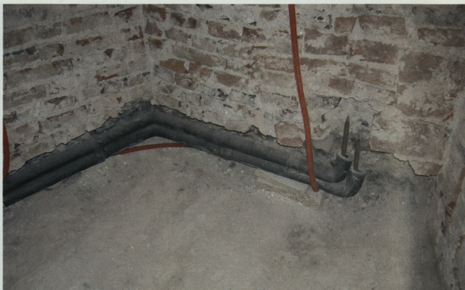
Slika 15 • Primer nedopustnega posega: horizontalni inštalacijski utor globine 30 cm pomeni izrazito oslabitev zidu, ki lahko privede do porušitve (ekscetričnost) že pri nižjih obremenitvah, da o potresni varnosti niti ne govorimo
