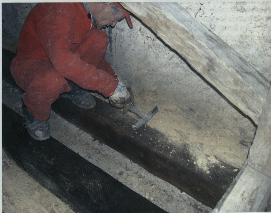
Slika 12 • Poškodbe lesenega stropnika, ki je bil po celi dolžini v stiku z injektiranim zidom in brez ustreznega zračenja
