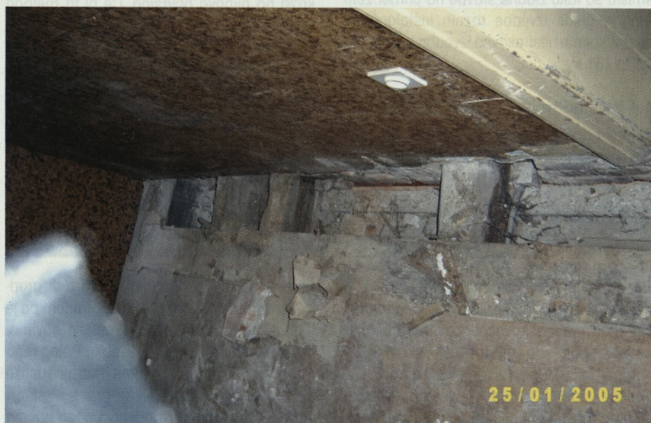
Slika 14 • Po odstranitvi zaključnih paroneprepustnih slojev tudi sicer popolnoma nestrokovno izvedenega sovprežnega estriha brez ustreznega sidranja so vidni prhli stropniki
