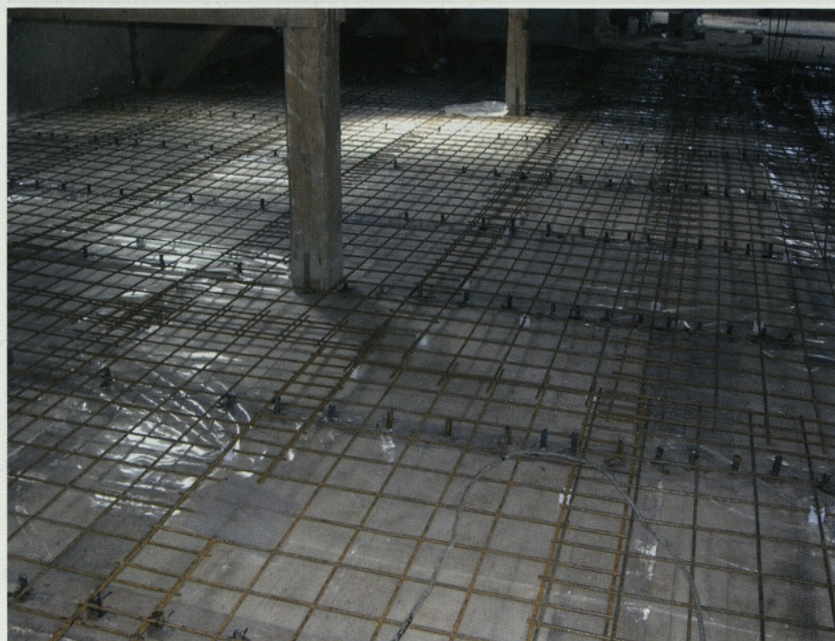
Slika 6 • Izvedba armiranobetonskega sovprežnega estriha: opaž med stropniki, folija, armaturene mreže, v stropnike vgrajeni moznički, še distančniki, pa bo pripravljeno za betoniranje
