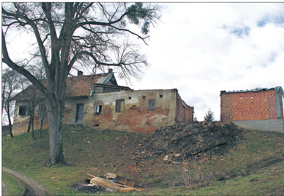
Ogenj je uničil ostrešje gospodarskega in del stanovanjskega poslopja, gradbeniki pa se bolj nagibajo k možnosti, da se zgradi nova hiša, saj stare najverjetneje ne bo mogoče obnoviti.
