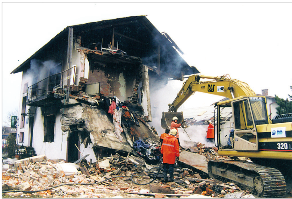
Pogled na razdejano hišo v torek, 15. februarja 2000, okoli 7.30, ko so bili na delu številni gasilci in sodni izvedenci, se je iz notranjosti in razbeljenih zidov še vedno kadilo.
