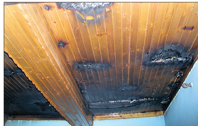
V spalnici so ognjeni zublji uničili streho in že začeli sikati skozi strop v prostor.
