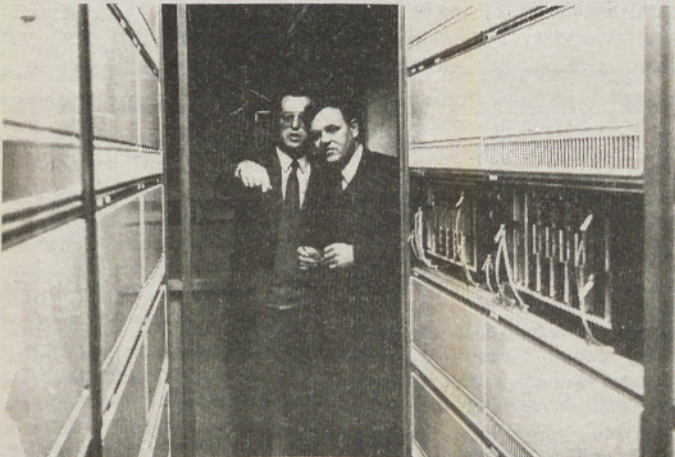
Na prvi pogled se zdi, da v prostoru, kjer je nova centrala, ni dosti kaj videti. Poznavalci telefonije pa seveda vedo, kaj vse skriva takšna centrala. (Foto: J. G.)
