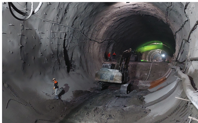
Slika 10. Na poškodovanih mestih je bilo treba izvesti reprofilacijo predora.
