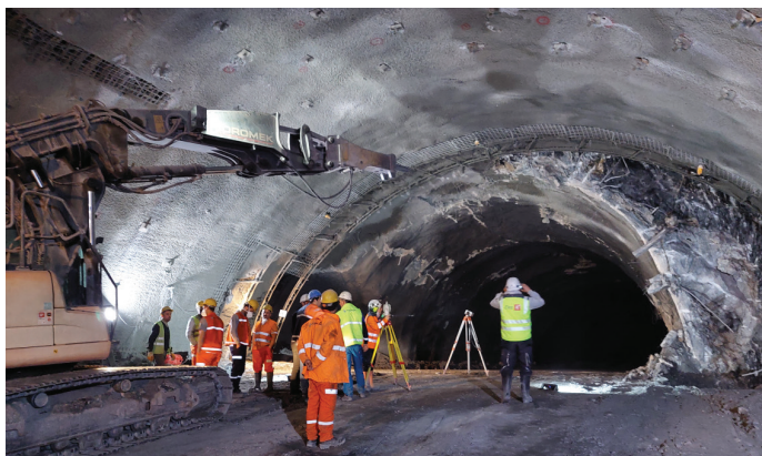
Slika 2. Izvedba prehoda iz območja razširjenega profila na območju odstavne niše v dvopasovni predor.
