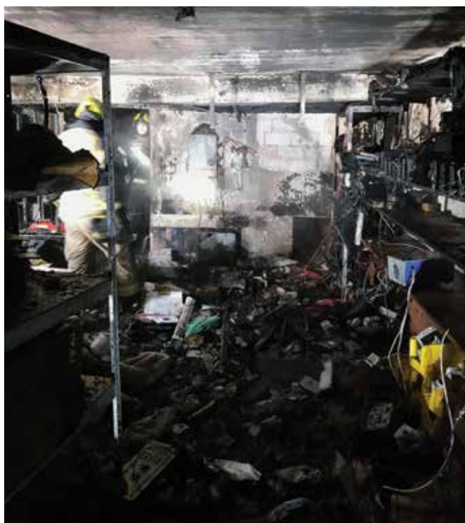
Slika 3: Garaža in oprema v njej sta bili v požaru popolnoma uničeni
