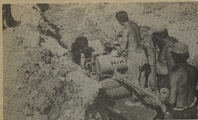
Za 1. fazo tovarne počitniških prikolic bomo postavili 3.700 metrov kabelske, meteorne in fekalne kanalizacije
