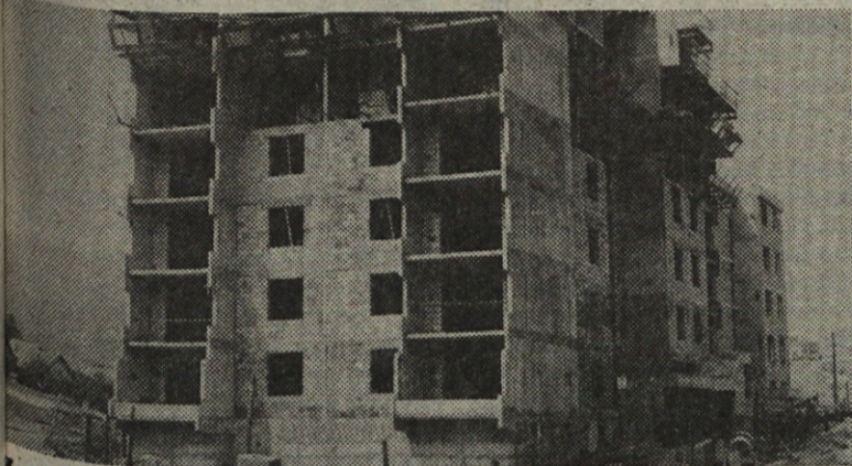
Zadnji stanovanjski blok, ki ga gradijo naši delavci na Javorniku na Ravnah
