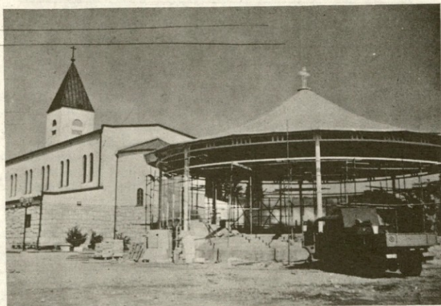
Montažna ekipa Induplati je v Medjugorju postavila kapelico iz kovinske konstrukcije. Po pripovedovanju delavcev je to ena od najzanimivejših montaž.
