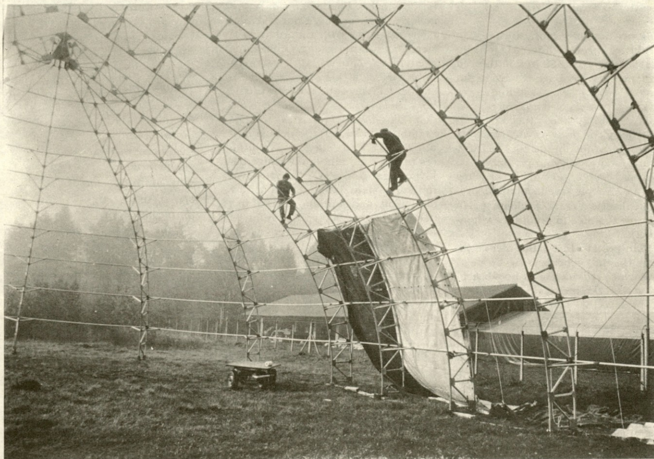
Montažna ekipa Induplati na terenu. O delu naših montažerjev objavljamo obširnejši zapis, ki ga je podal njihov vodja Jože Knep.
