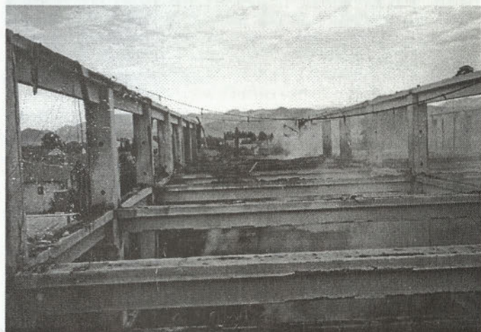
Še pred kratkim zelo dobro skladišče, je bilo le še ogrodje.
