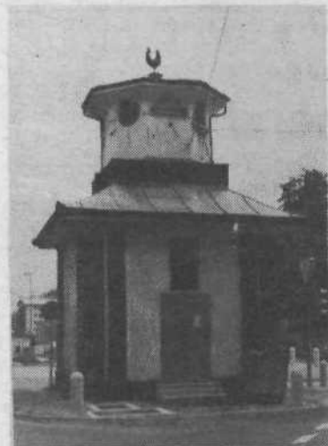
– Transformatorska postaja pri nekdanji Klavnici v KS Nove Poljane
