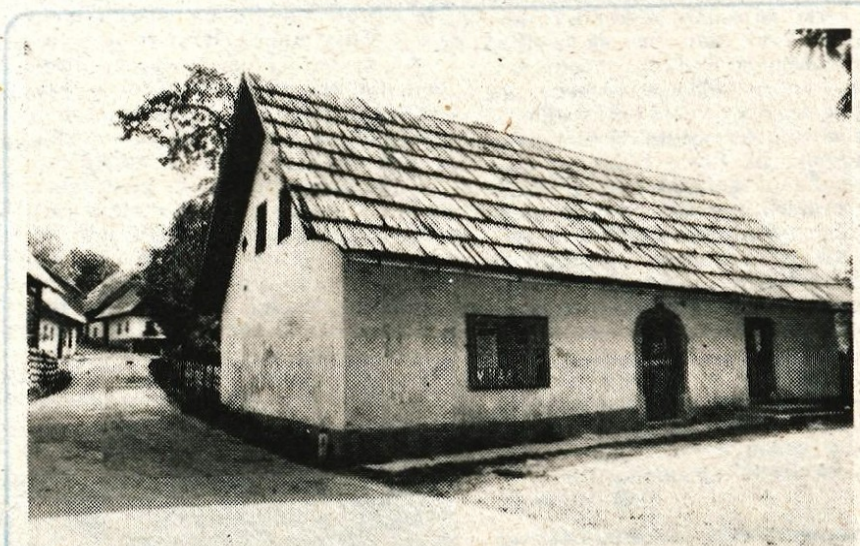
Krajevna skupnost ima prostore v starem, dotrajanem objektu, kjer se je zadrževati že nevarno...
