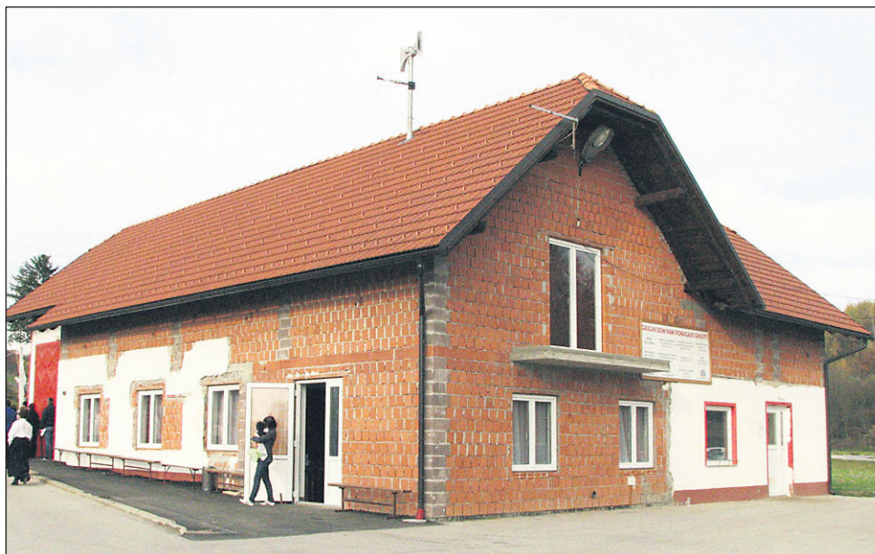
Foto: Viki Ivanuša Gasilski dom v Trnovcih potrebuje še fasado. Mirko Lovrec, predsednik GD Trnovci, je prepričan, da jim bo uspelo do poletja dela na domu končati.
