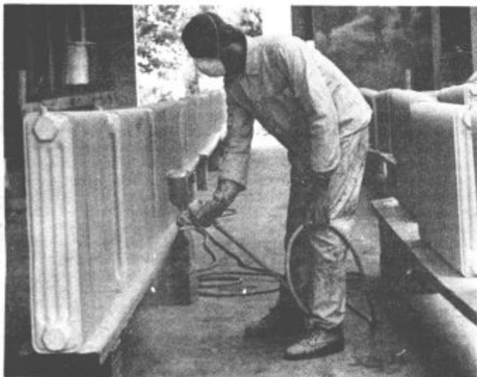
Z radiatorji je veliko dela že pred postavitvijo v stanovanje
