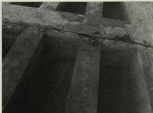
Slika 9. Poškodovan členek prekladne konstrukcije
