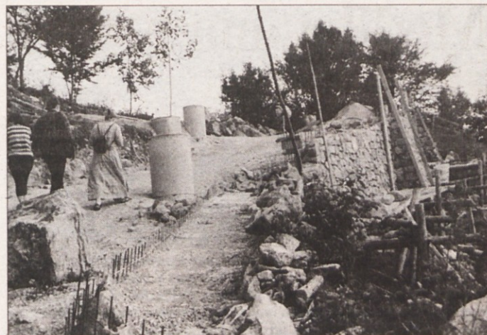
OBNOVA CESTE NA GRAD KOSTEL - Sočasno s posodobitvijo zemljišča so sanirali tudi stari podporni zid ob cesti (na posnetku), ki je grozil, da se bo zrušil, s tem pa bi se odrgala tudi cesta. (Foto: M. L.-S.)
