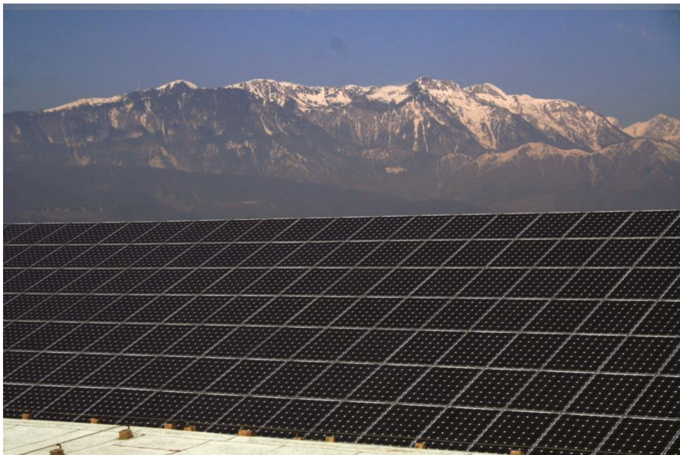
Konstrukcija na strehi bivše tovarne Stol v Kamniku je največja strešna sončna elektrarna v Sloveniji.
