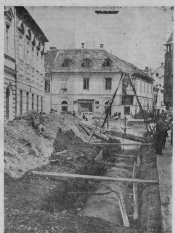
Polaganje nove kanalizacije po Ptujju je prodrlo v središče mesta. Sedaj je razkopan Trg mladinskih delovnih brigad, kjer so v teku kanalizacijska dela, ki bodo napredovala dalje po Miklošičevi ulici. Ko bo urejena v Ptujju tudi kanalizacijska mreža, ne bo več nikakšnih potreb za razkopavanje ozkih ulic, ki čisto zapre promet
