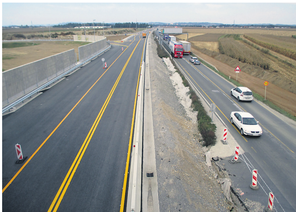
Omejitve hitrosti bo zaradi gradbišča tudi na asfaltu bodoče avtoceste ostala 50 kilometrov na uro. Foto: EM
