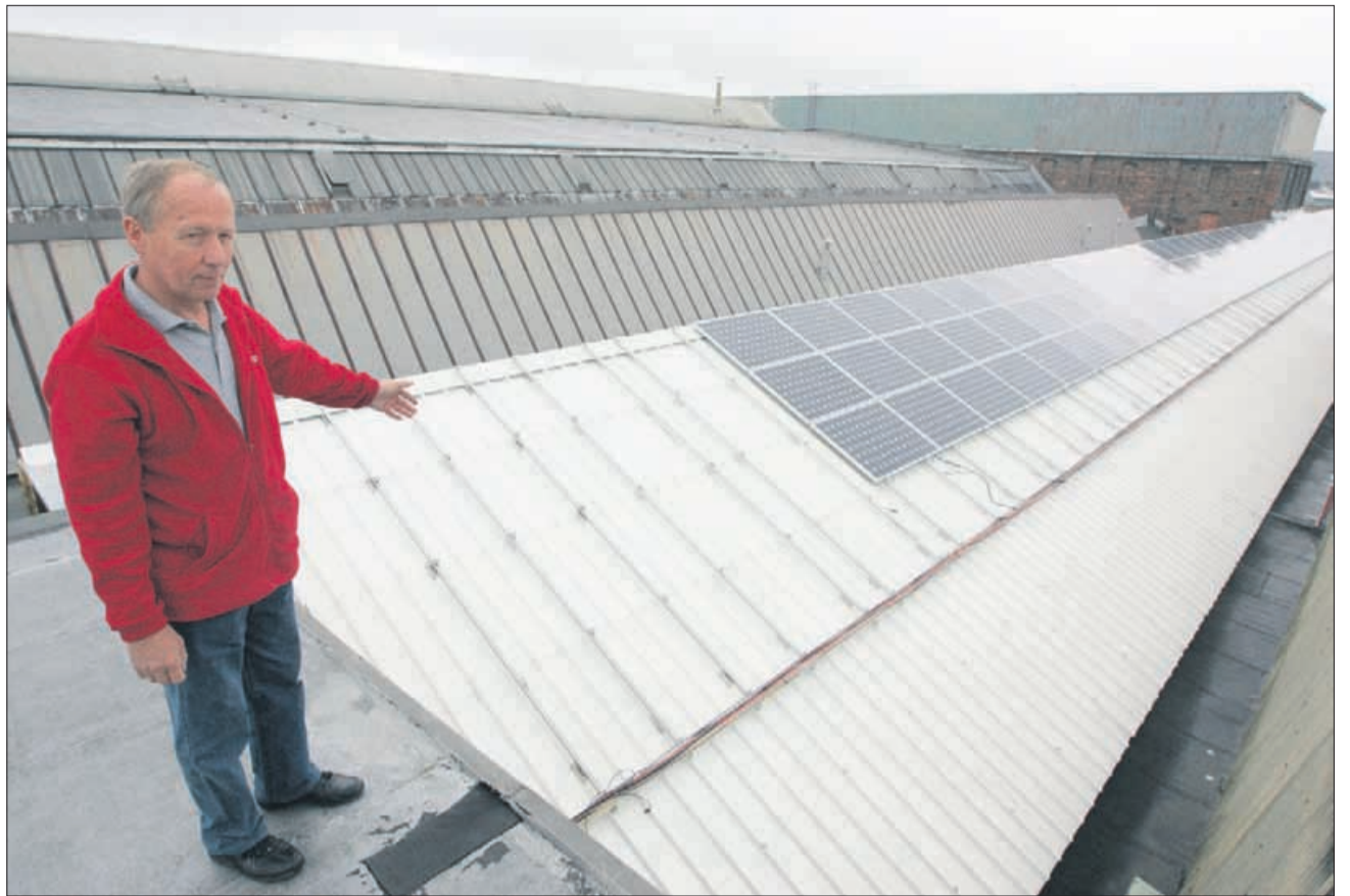
Na neskladje in zmešnjavo kaže streha Elektra Turnšek. Bodo odstranjene module po pridobitvi gradbenega dovoljenja sedaj ponovno sestavljali nazaj, se sprašujejo.
