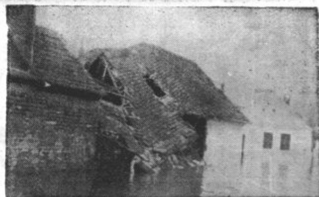
Porušena hiša, kakršnih je več sto porušila voda v predmestjih Novega Sada in tudi v Sremskih Karlovcih
