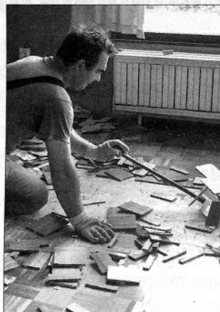
Zaradi poplavljenih igralnic so morali v nazarskem vrtcu odstraniti uničeni parket (foto: Irena Drobež)
