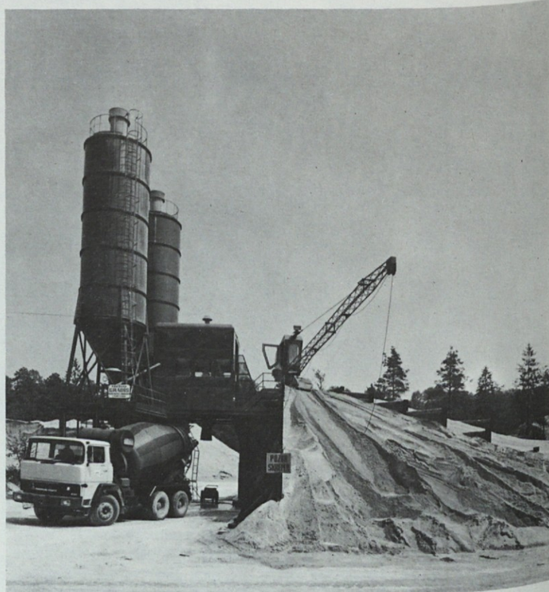
Gradisova stabilna betonarna
