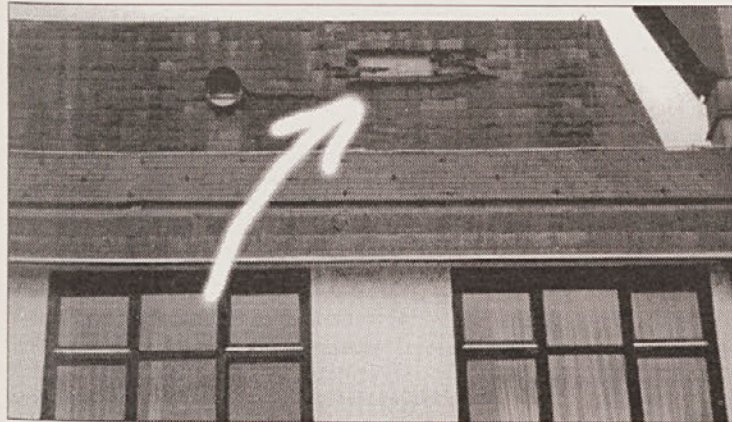
Zaradi slabo opravljenega dela, streha že vrsto let propada!
