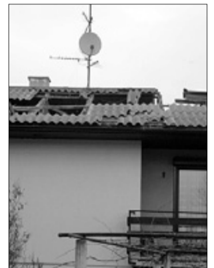
Poškodovana streha v Šmihelu E. ČURLIČ
