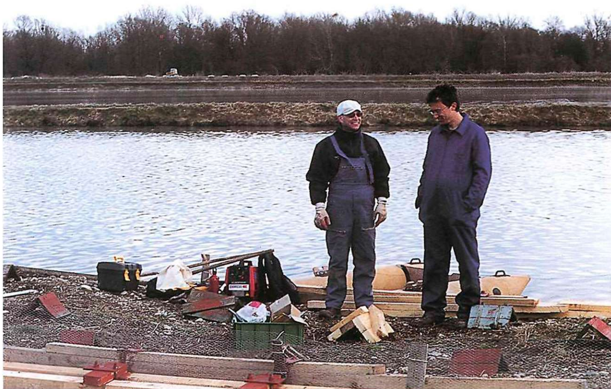
Pri popravilu splava v bazenu za odpadne vode Tovarne sladkorja Ormož, se nam je pridružil tudi Paul (na levi).
