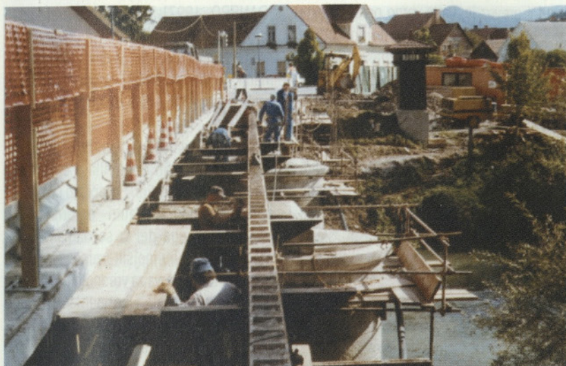
Slika 6.5: Most čez Ljubljanico na Vrhniki na cesti R3-642/1146 (Izv. del: GP Gradis Lj. - 1998; vrednost del: 70 mio SIT)
