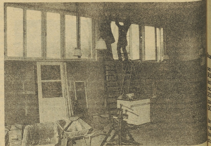
Gradbena dela v obratu TOZD TV Pržan v Višnji gori lepo napredujejo.
