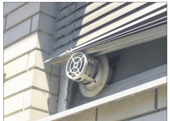
Odvodnik plinskega trošila kar skozi okno ... Kje je inšpekcija? (Foto: Celjski dimnikarji)
