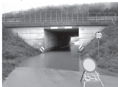
Podvoz za Paradišče je bil 9.55 zalit s pol metra vode.
