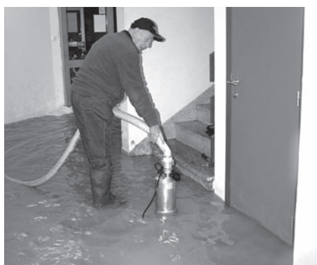
S potopno črpalko na hodniku gasilskega centra.
