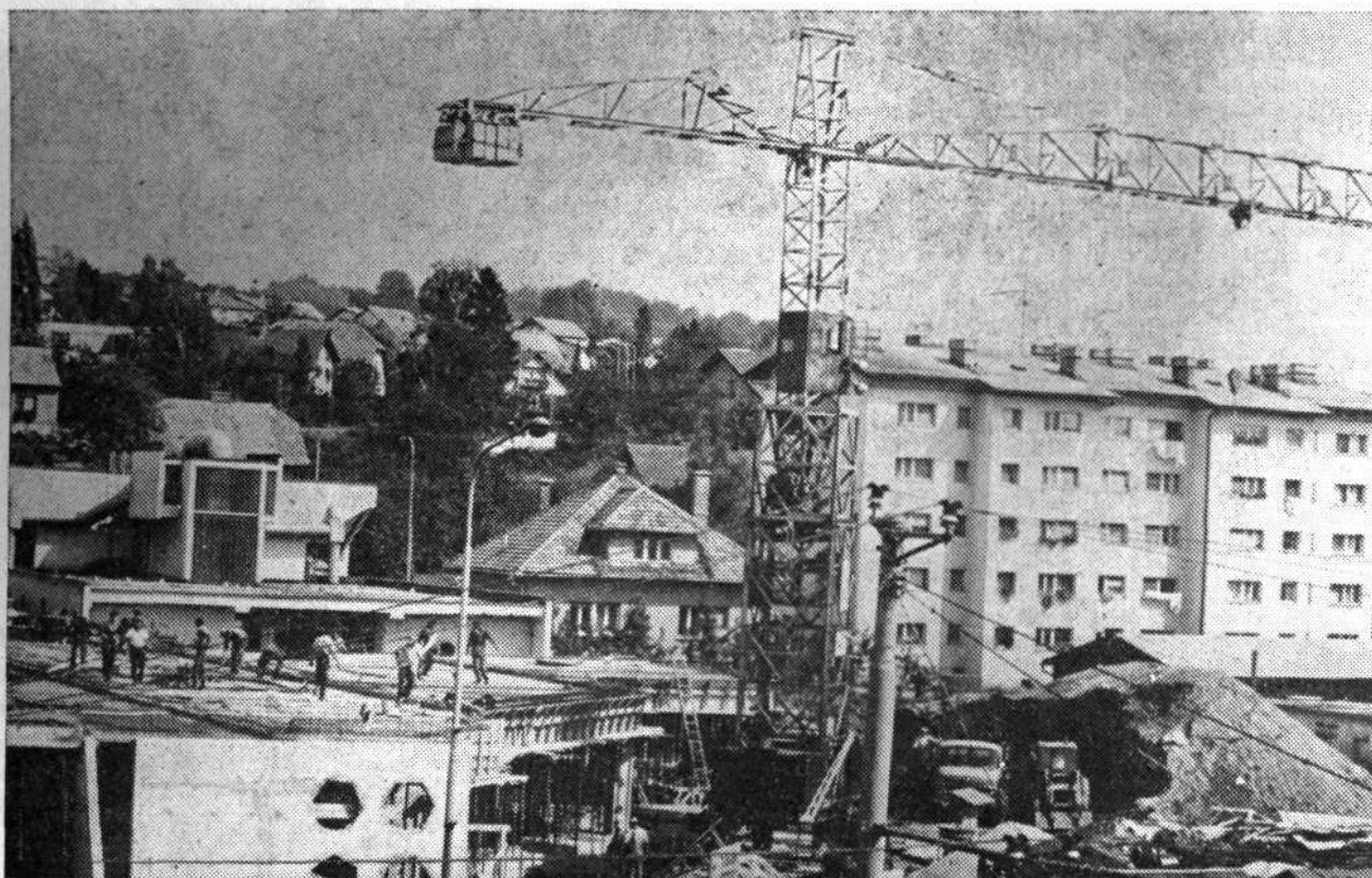
Gradbišče krške tržnice: med železniško progo in trgovsko polovalnico, ki so ji ljudje nadeli ime »podmornica«, raste bodoče oskrbno središče, ki so ga potrošniki vrsto let pogrešali
