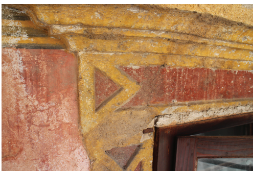
Zbirka poškodb na kamnitem okvirju: plasti nečistoč, poves, razpoke, grobe domodelacije, kovinski vrviki, izsoljevanje, odlomi in odkruški. (foto: Saša Stržinar, september 2015)
