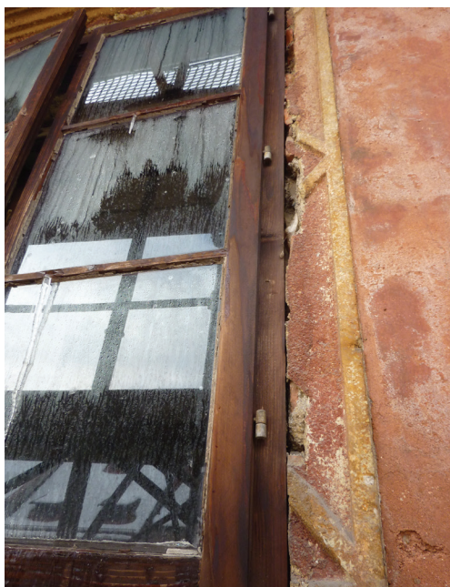
Okvirji zgornjih oken, poškodovani zaradi vgradnje okna na zunanji strani. (foto: Mateja Kavčič, januar 2015)
