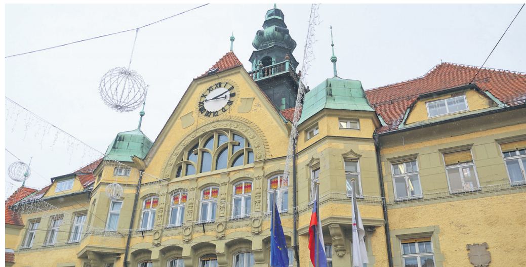
Zraven obnove ostrešja bo nujno treba zamenjati tudi stavbno pohištvo, pa še marsikaj drugega.
