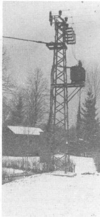
Transformator v Iški, ki je bil zgrajen lani.
