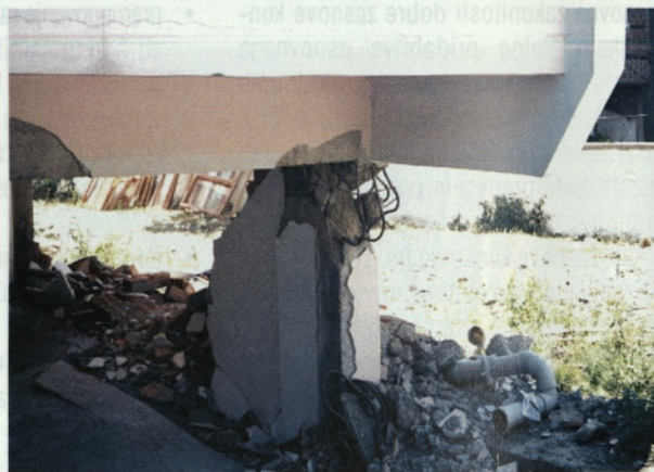
Slika 12: Poškodbe kratkega stebra z nezadostno stremensko armaturo (uklon vzdolžne armature)
